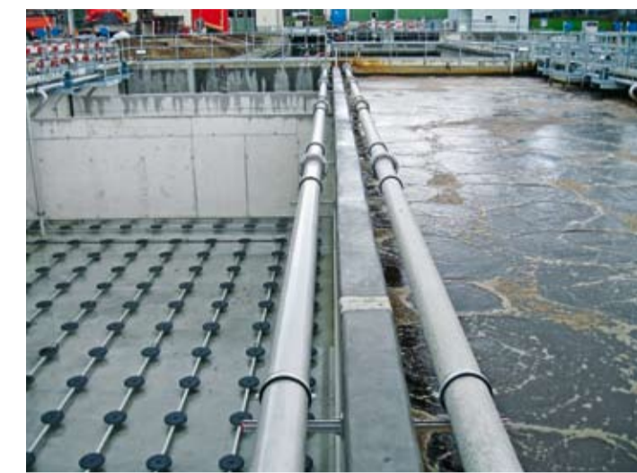
Belüftungsbecken leer mit Belüftungseinrichtungen (links) und in Betrieb (rechts)
